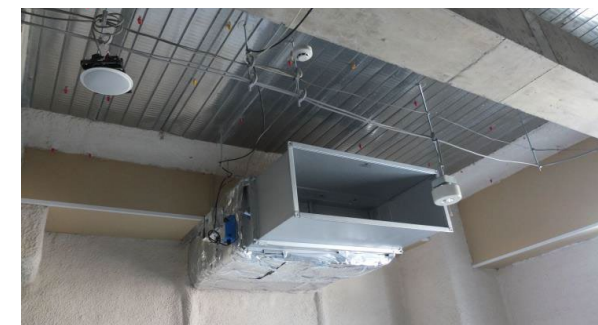
▲ 強力な排気用ダクト設備
