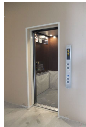
▲ 内部のエレベーター（2基）
