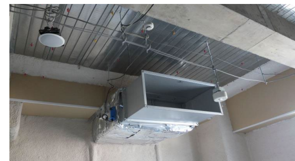
▲ 強力な排気用ダクト設備
