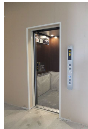
▲ 内部のエレベーター（2基）
