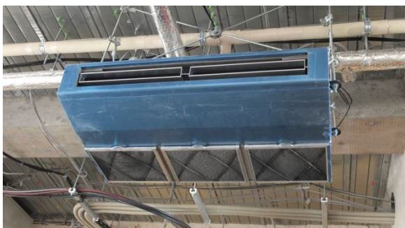
▲ 厨房用の冷暖房機 2 台設置
