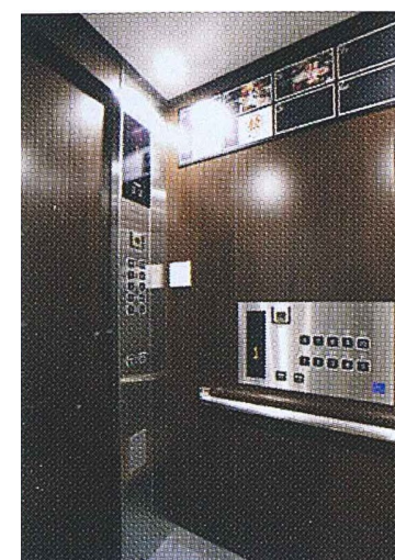
エレベーター内部
