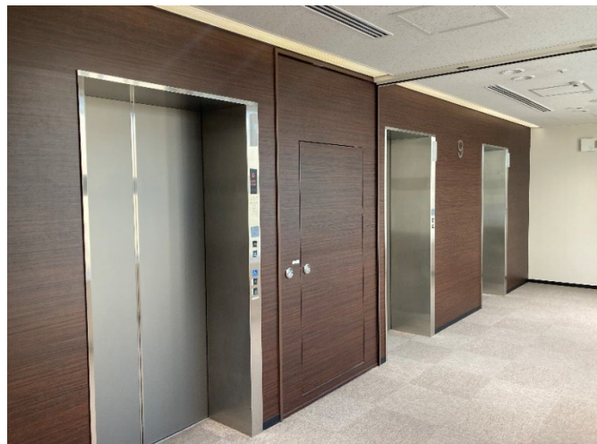
エレベーター
