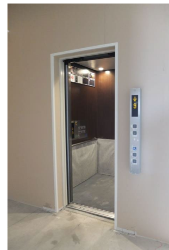
▲ 内部のエレベーター（2基）
