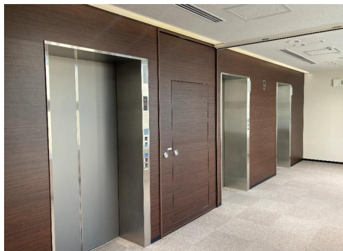
エレベーター
